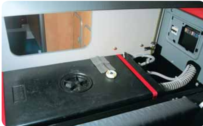
Versteckt, aber zentral: Im Küchenblock unter der Bettverlängerung machen sich Frischwassertank, Aufbauabatterie und die Sicherungen breit.
